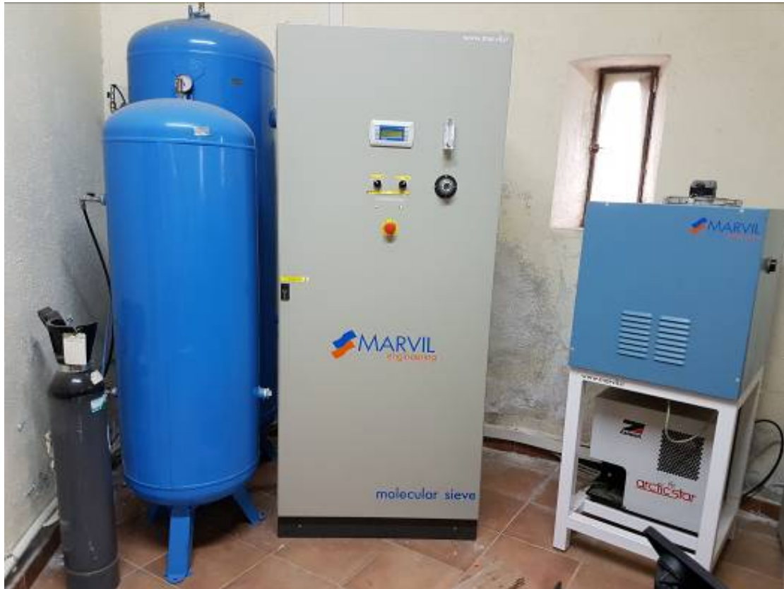
Figura 9. Apparecchiature di supporto per il liofilizzatore e l'impianto di climatizzazione delle teche del Museo Micologico di Acri (CS)
